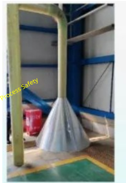
泄漏液氯汇集地沟
