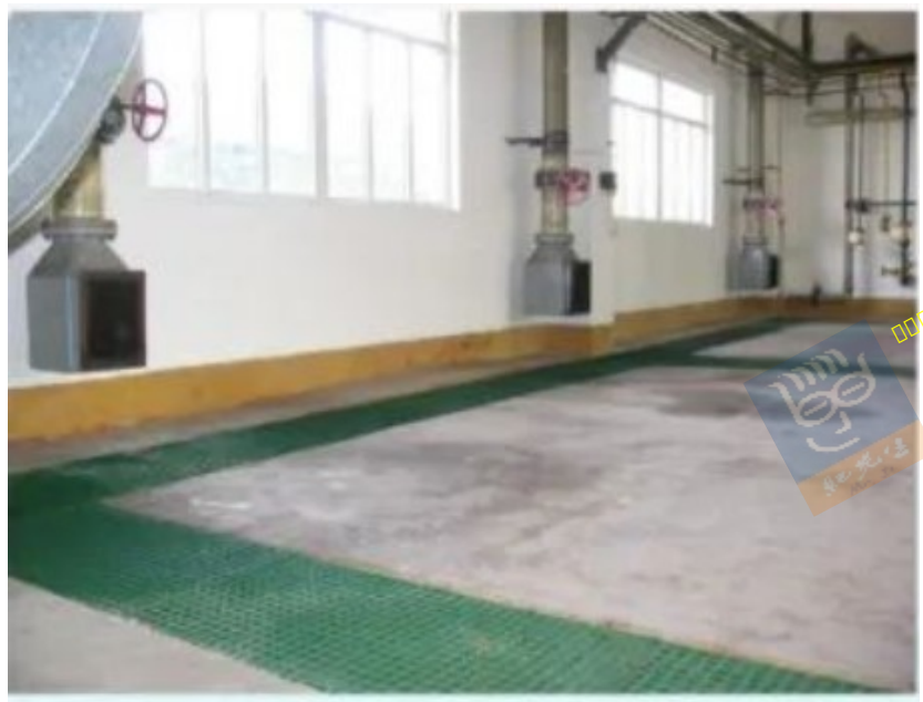
液氯库内吸风口和液氯汇集地沟
