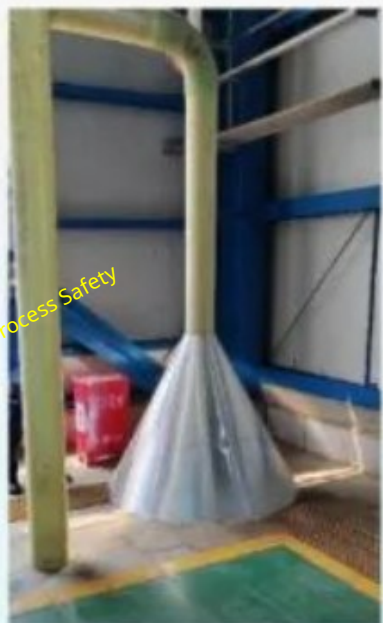
泄漏液氯汇集地沟
