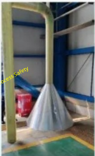
泄漏液氯汇集地沟
