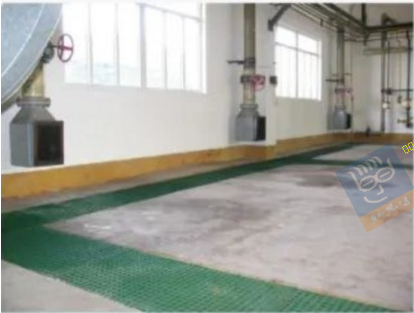
液氯库内吸风口和液氯汇集地沟
