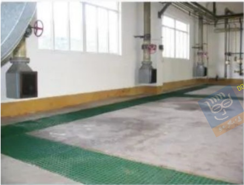
液氯库内吸风口和液氯汇集地沟
