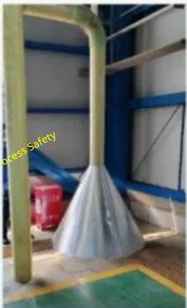
泄漏液氯汇集地沟
