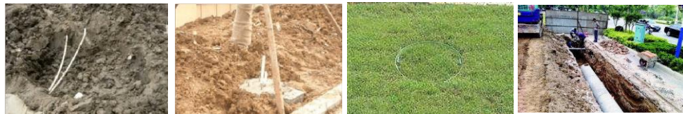
树穴内有电缆（错误做法） 路灯与树太近（错误做法） 窨井盖隐藏进草坪（正确做法） 管道安装配合土方作业
