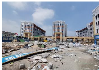
场内建筑垃圾较多
