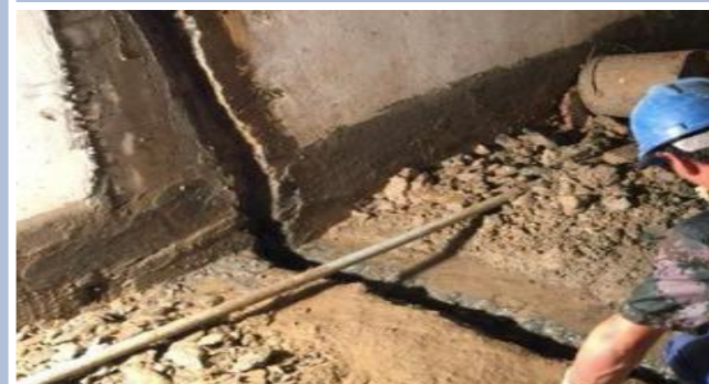
施工连通口渗水
