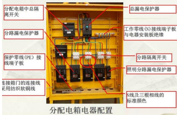
分配电箱电器配置
