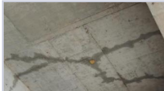
管线集中处裂缝渗漏示意图
