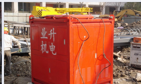
液压泵源系统
