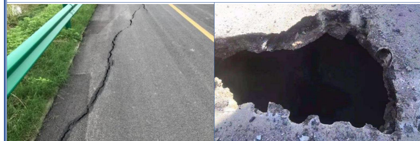
道路不均匀沉降 道路下空洞
