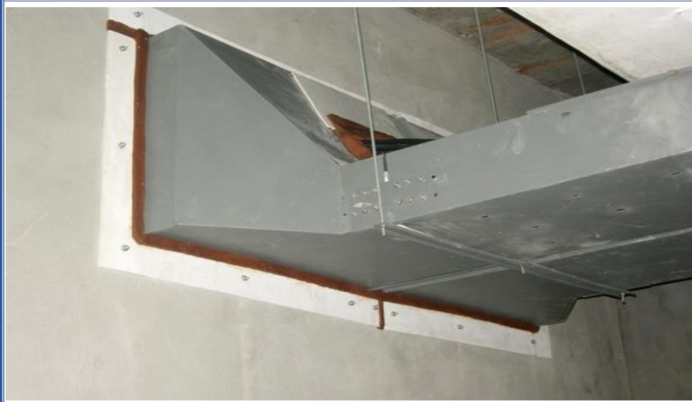
3) 配电盘、柜的防火封堵
