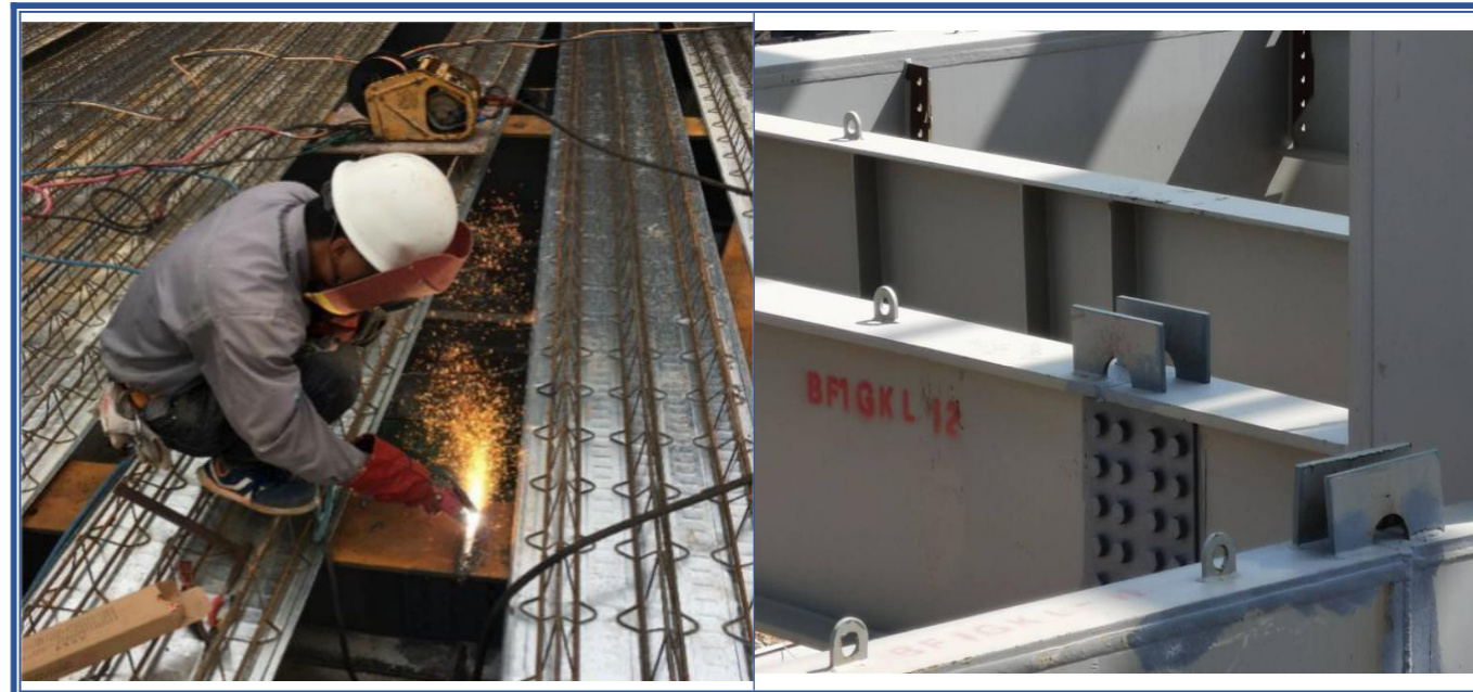
(四)、安装时随意切割钢构件，导致切口处缺陷多
