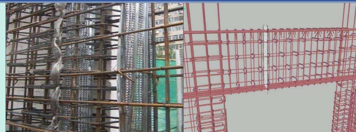
墙体竖向施工缝
