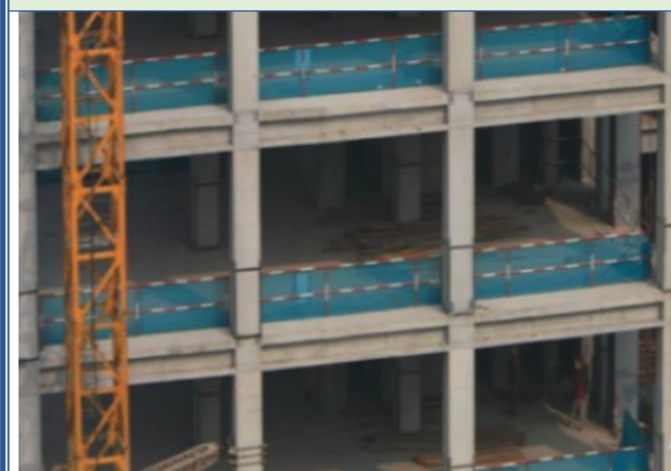
楼层临边防护
