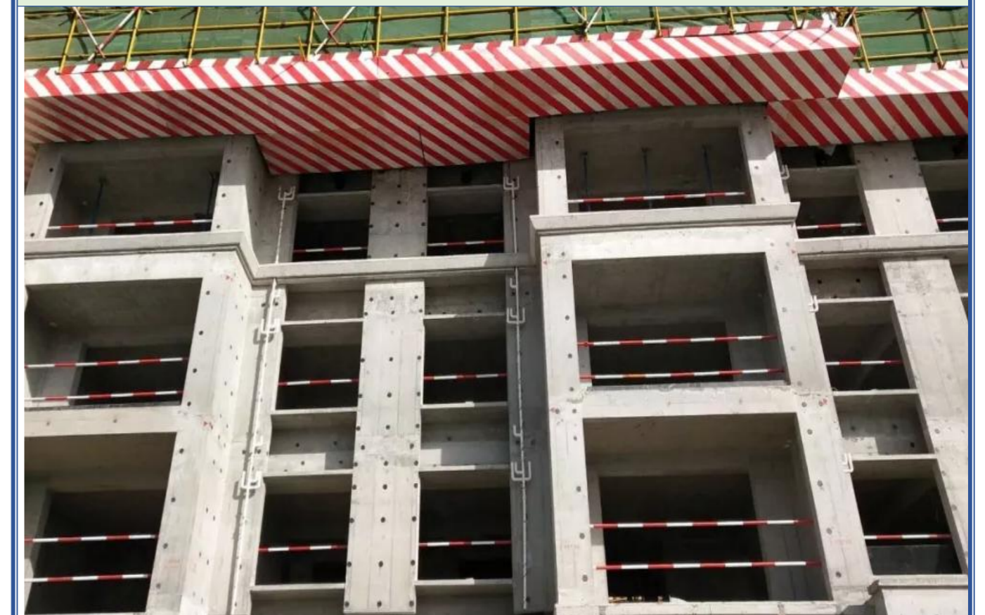
楼层临边防护
