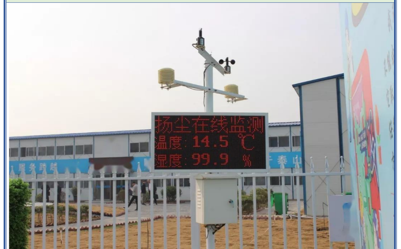
扬尘在线监控
