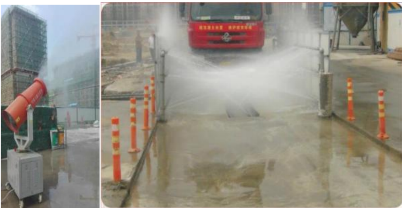
雾炮降尘及车辆自动冲洗装置
