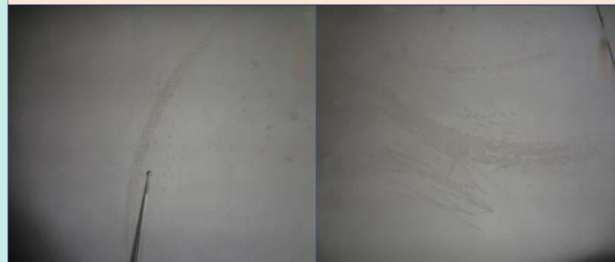
抹灰面砂浆强度不足，存在掉砂现象
