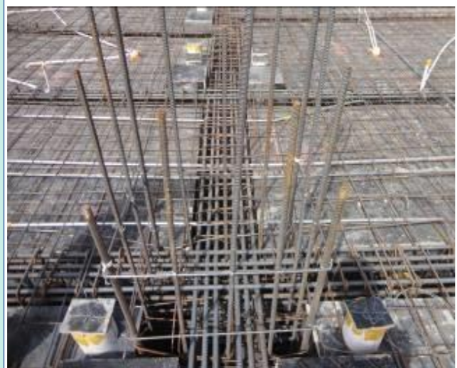
框架柱机械连接相邻接头未错位连接
