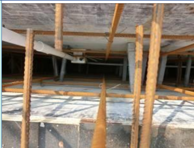
剪力墙钢筋拉钩设置数量不足
