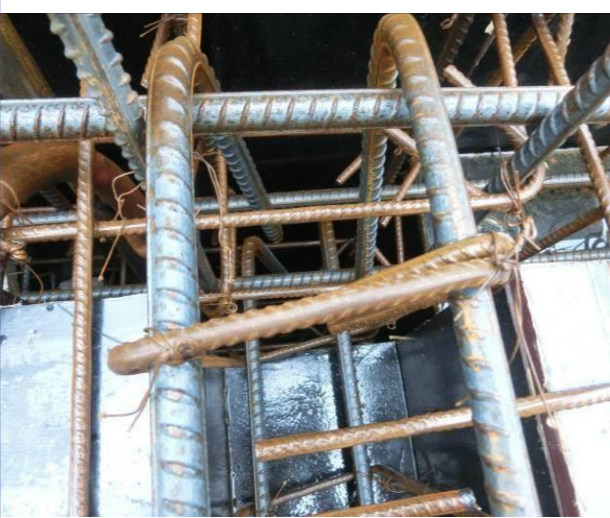
梁支座底部钢筋弯锚方向错误
