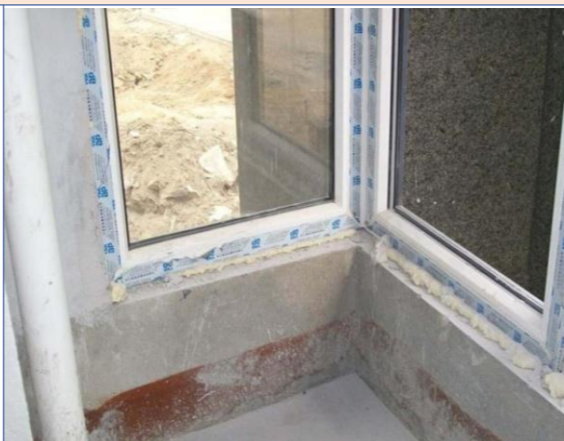
窗框左方和拐角处都未打发泡剂
