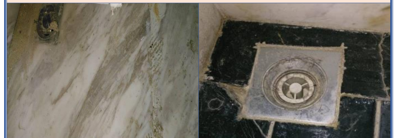
地漏安装高度与地面完成面积水
