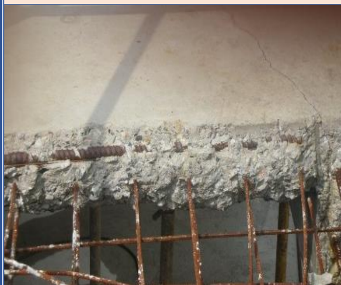
负筋保护层过厚，板面开裂
