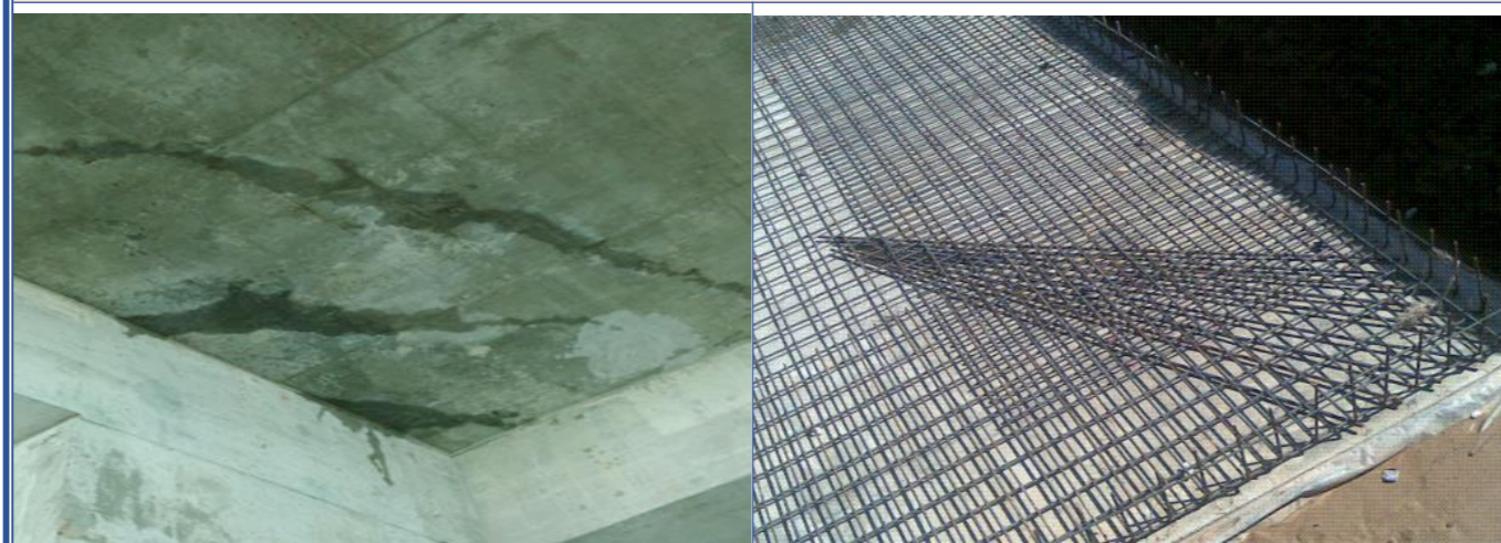
板角裂缝渗漏
