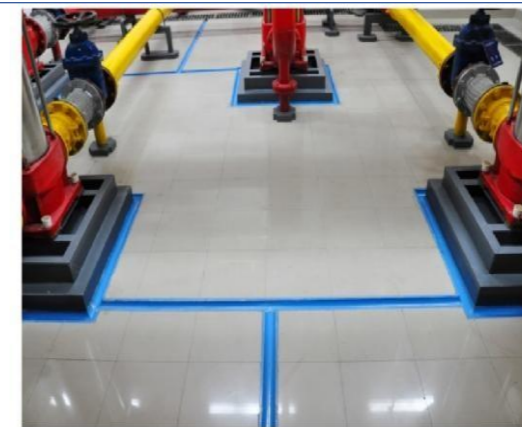
消防泵周围设置半圆形排水沟，形成有组织排水
