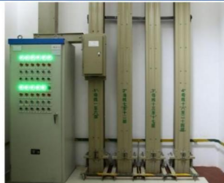
强电间配电柜、母线排列整齐，接地可靠，封堵到位
