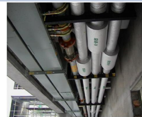
吊顶内同程敷设的水管和强、弱电桥架分别采用共用支架分设在两边，综合排布合理有序，接地可靠，标识齐全清晰，管线伸缩补偿到位，明暗敷设质量一致
