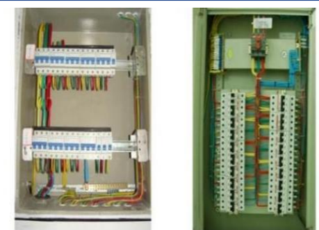
箱内配线整齐、绑扎牢固、接线正确。导线连接牢固，不伤线芯、不断股，接线端子每个螺丝压接导线不应超过2根，导线绝缘层剥除长度以垫片边缘或紧贴孔边为宜，多股导线应剥锡或压接专用鼻子
