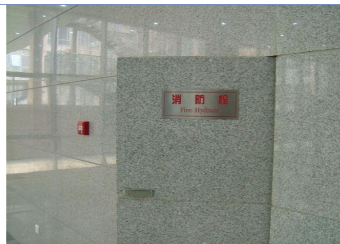
消火栓及报警装置
