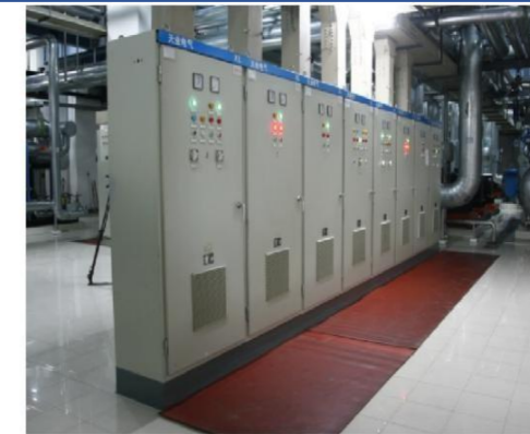
设备机房成排电柜排列整齐，基础设置规范，绝缘地毯敷设到位
