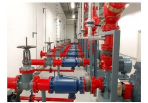
从水箱吸水管到消防水泵进水口应安装：控制阀、过滤器、偏心异径管和软接头，其中控制阀不应采用没有锁定装置的蝶阀，偏心异径管安装采用管顶平接
