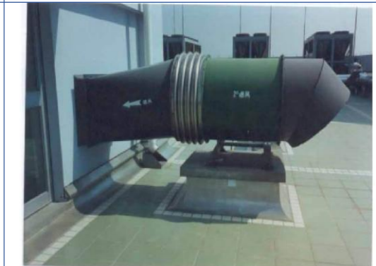
屋面风机与风管间采用不锈钢软接，抗腐蚀、老化
