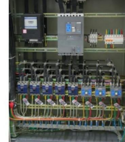
配电柜(箱)母线集中排列在人员接触处应设不燃透明挡板或将母线包裹绝缘层，以确保操作安全
