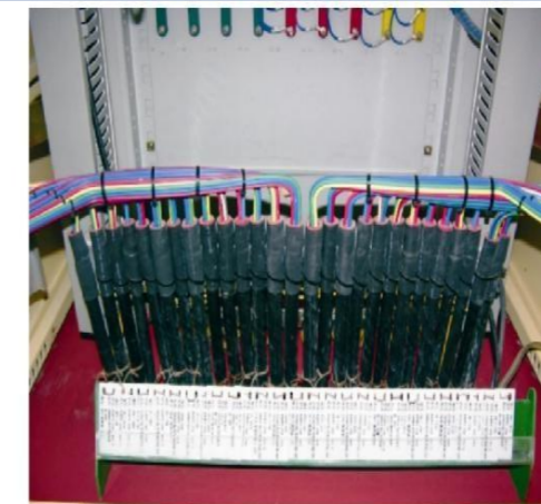
电缆头采用热缩新材料，电缆牌标识清楚，便于查找
