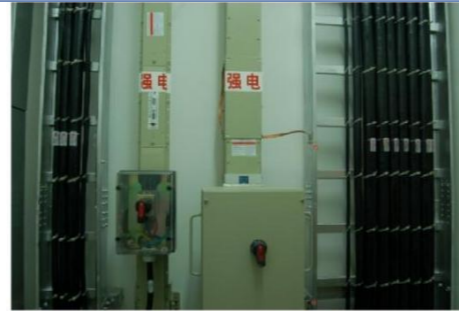
母线、桥架、电缆设置合理，排列有序，接地可靠，标识清晰
