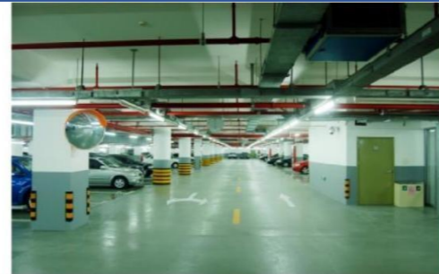
车库灯具安装在桥架下，固定牢固，排列整齐。当灯具距地面高度小于2.4m时，灯具的可接近裸露导体必须接地(PE)或接零(PEN)可靠，并应有专用接地螺栓，且有标识
