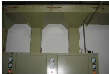
桥架分支处采用定制锥形三通，接地跨接到位
