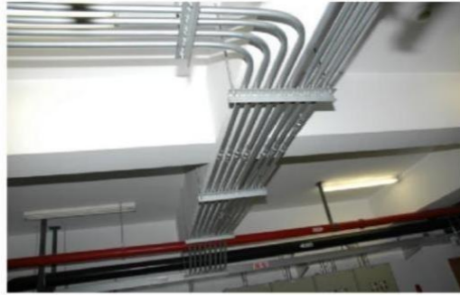
成排管线采用共用支架，排列整齐。支架设置位置合理，防腐到位
