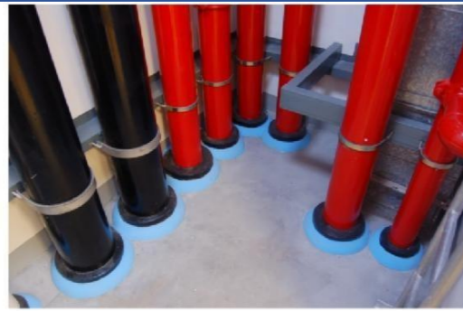
穿越楼层板面的管道封
