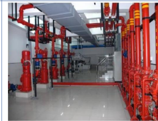
成排水泵和湿式报警阀布局合理，间距均衡，安装规范。水管安装横平竖直，成排支架排列整齐，标识齐全
