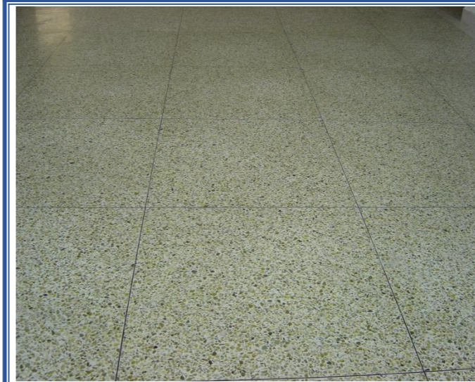
水磨石面层，表面光滑，与基层结合牢固，无空鼓、裂纹
