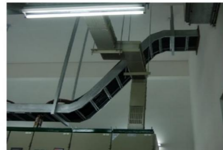
Z字型梯架过渡自然圆滑，转弯处支架设置到位
