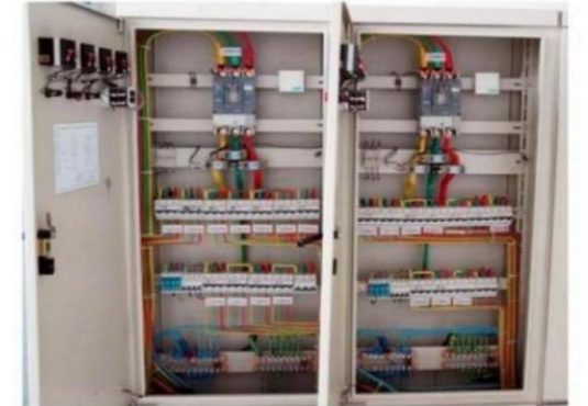
配电柜内导线走向合理，绑扎牢固，接线正确，标识齐全。三相五线制供电回路中，配电箱内应分别设置零线(N)和保护地线(PE线)汇流排，零线和保护地线经汇流排配出。N、PE排应用镀锌铜母线，各回路的零线和保护地线不得绞接，应按回路分别接于零排和接地保护排上
