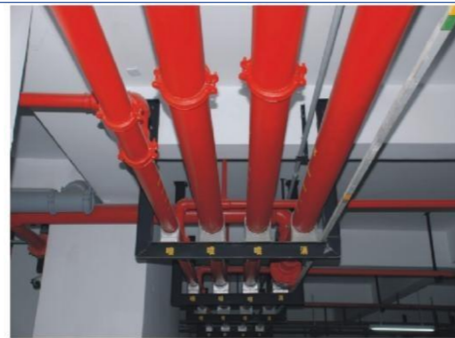
成排管道采用共用支架，用途标识明确。管道采用半圆型面接触托架，受力均衡。
