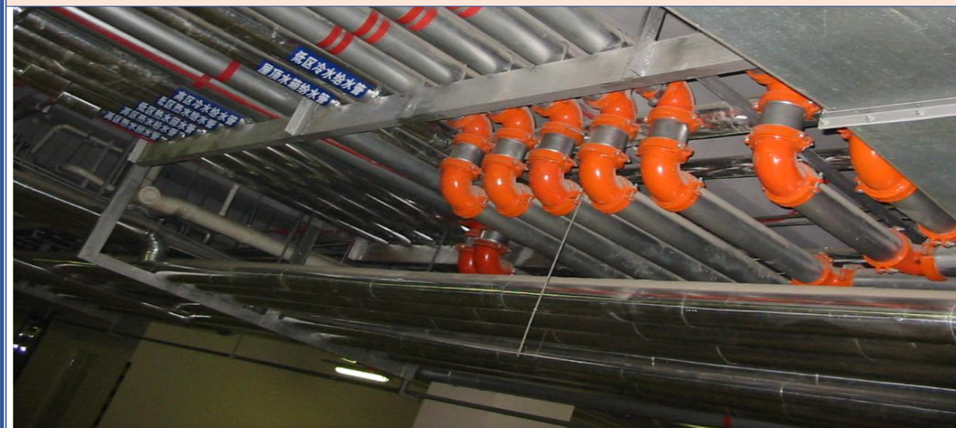
管线布局合理，排列有序，层次分明，横平竖直，坡向正确
