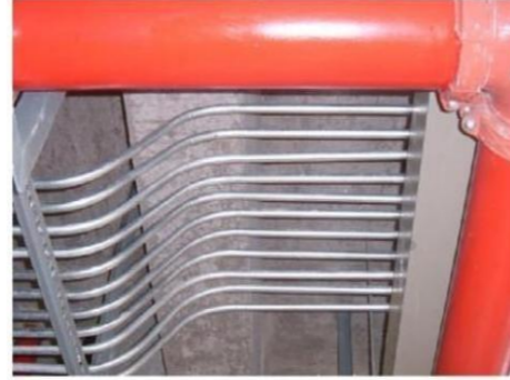
成排管线上返弯曲弧度一致，排列整齐，固定牢固
