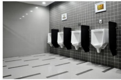
成排后落水感应式节水小便器安装
