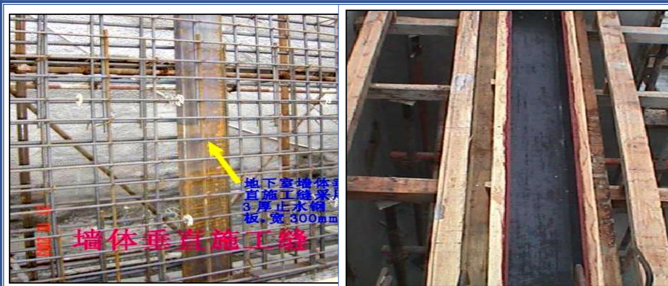
墙体垂直施工缝
