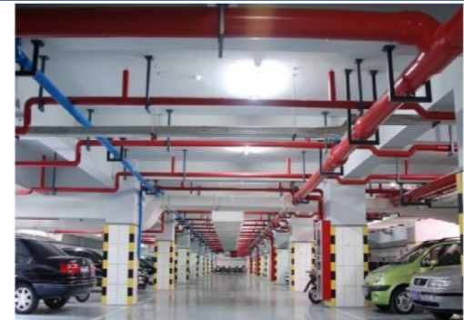
管道、支架排布成行成线，整齐美观，色标明确。成排支架结构正确、设置位置合理、制作工艺精细、防腐到位
