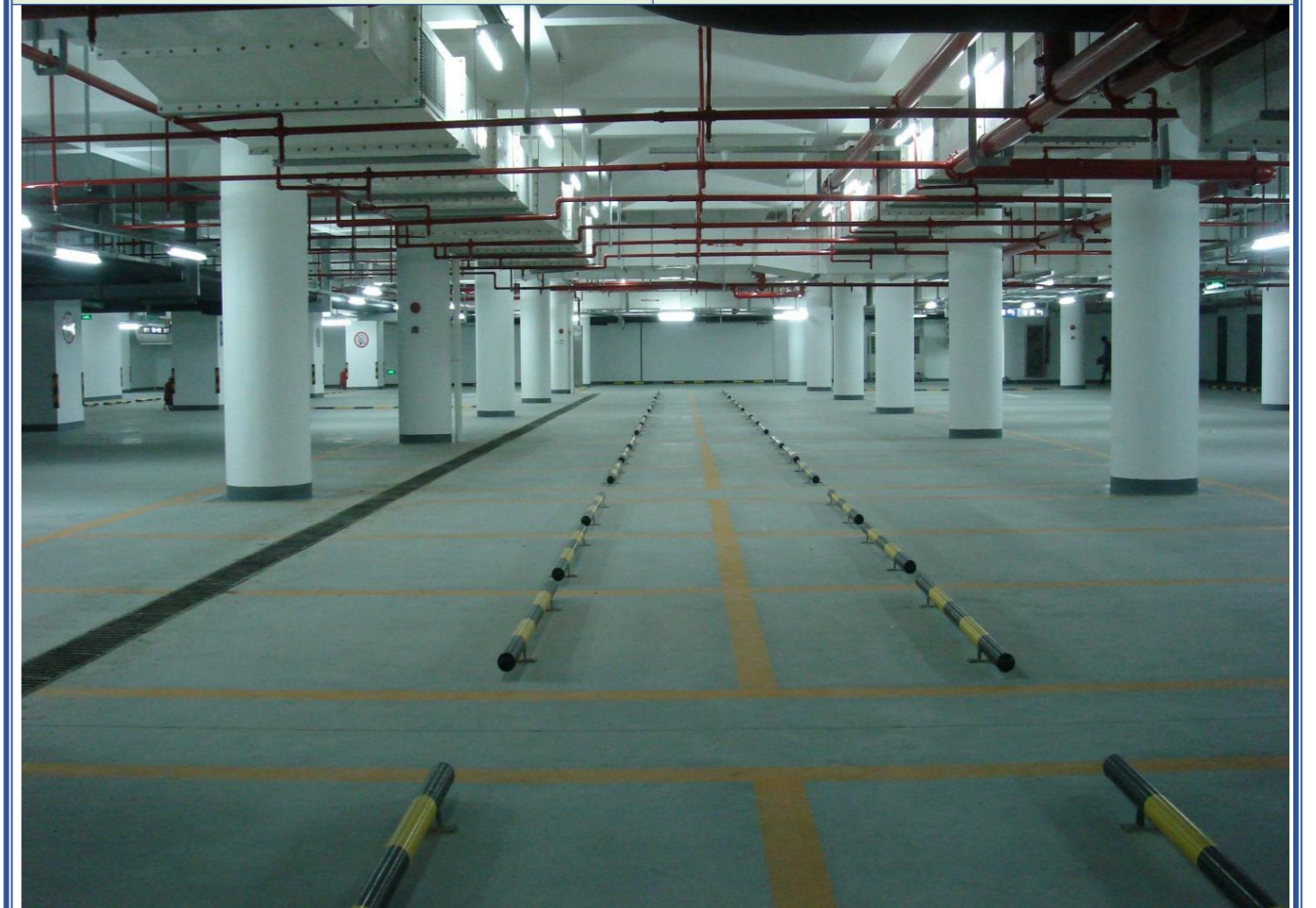
地下室细石混凝土面层次压光，无裂缝、脱皮、麻面、起砂等缺陷，与基层结合牢固，不空鼓
