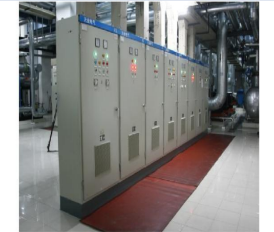
设备机房成排电柜排列整齐，基础设置规范，绝缘地毯敷设到位
