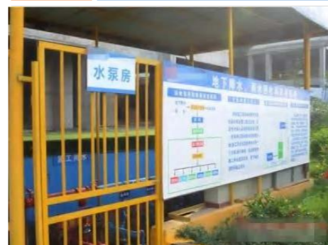
地下水利用智控系统
